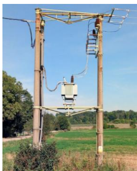
Obrázek 34: Trafostanice 2, Zdroj: vlastní zpracování
