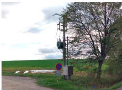
Obrázek 40: Trafostanice 8, Zdroj: vlastní zpracování
