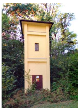
Obrázek 35: Trafostanice 3, Zdroj: vlastní zpracování
