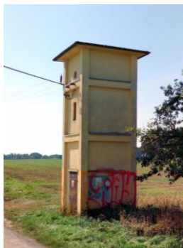
Obrázek 33: Trafostanice 1, Zdroj: vlastní zpracování
