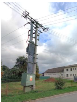
Obrázek 36: Trafostanice 4, Zdroj: vlastní zpracování
