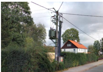
Obrázek 39: Trafostanice 7, Zdroj: vlastní zpracování
