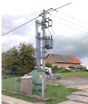
Obrázek 37: Trafostanice 5, Zdroj: vlastní zpracování
