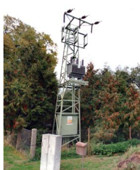
Obrázek 38: Trafostanice 6, Zdroj: vlastní zpracování
